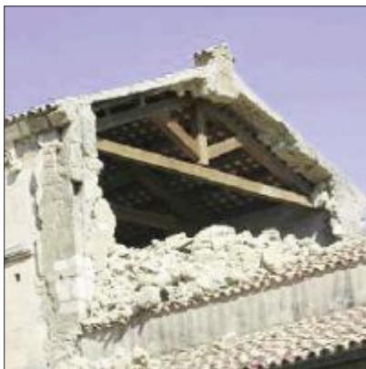
Il timpano danneggiato dal terremoto
